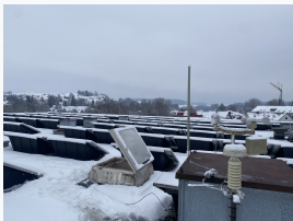
Die Antenne des Gateways, montiert über Dach
