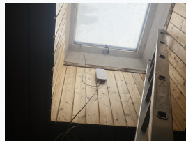
Das Gateway selbst, im Inneren des Gebäudes
